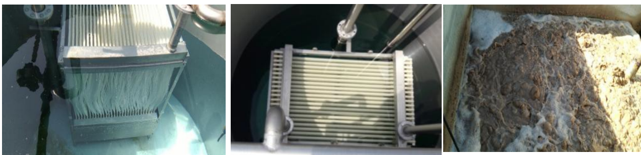
Fig. 5 – Membrane UF posizionata e in filtrazione
